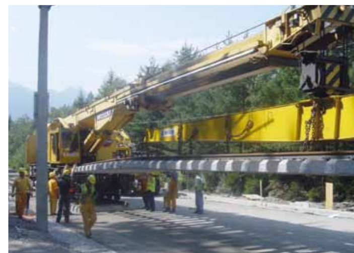
Symbolbild eines schienengebundenen Kranes – mit ihm werden die schweren Teile aus- und eingehoben. (Fotos: ÖBB)
