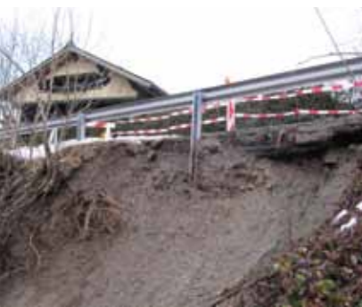
Unterspülung in der Oberwindau
