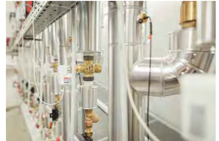
Die Heizungsanlagen von Betrieben bergen Potenzial zur Steigerung der Energieeffizienz im Tourismus (Bild: Energie Tirol).
