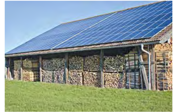
In Deutschland ein gewohntes Bild: Photovoltaikanlage auf einem Wirtschaftsgebäude
